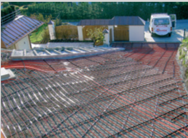
Aplicación en exteriores: Rampa de acceso al garaje sin hielo ni nieve
